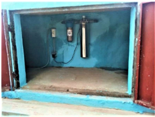
Die Waterflow Anlage.
