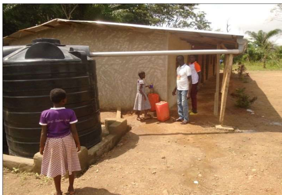
Wassertank für Regenwasser
