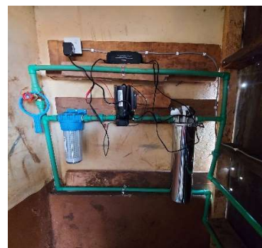
Vorfilter > Pumpe > Feinfilter
