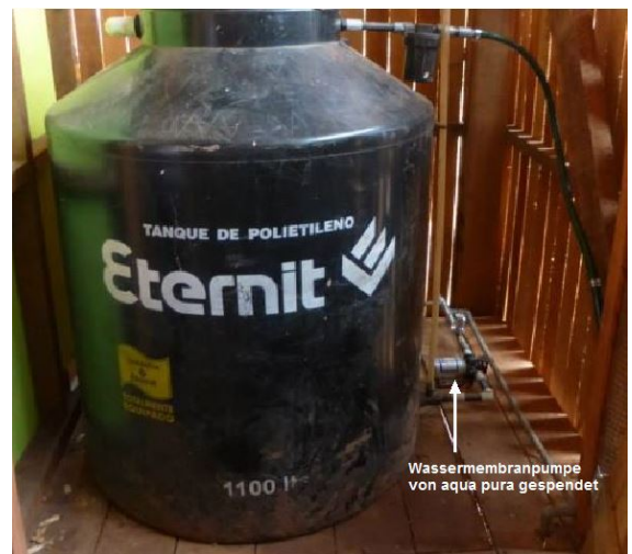
Wassertank mit Shurflo-Membranpumpe
