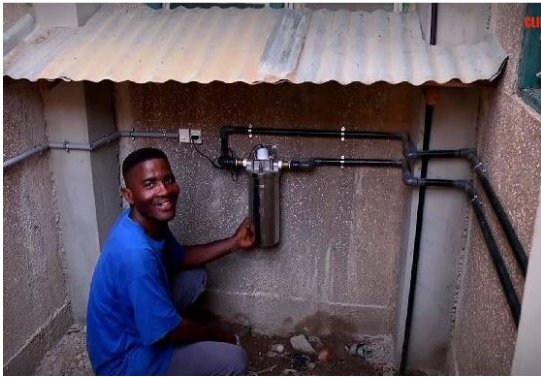
Claude mit dem installierten Waterflow 200 System
