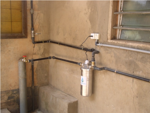
Beispiel einer ganzen Trinkwasseranlage mit PVC-Rohren, installiert in KPalimé Togo
