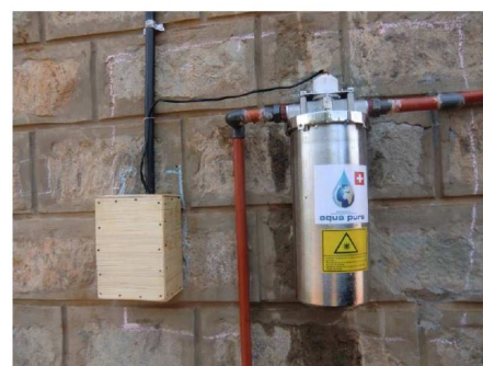
Bild 3: Abdeckung für die Strombuche.
