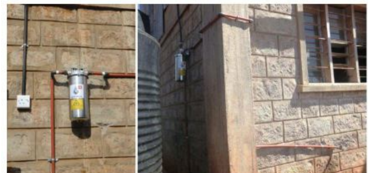
Bild 2: Links: Installierter Filter mit PPR Leitungen. Rechts: Wasserumleitung um die Ecke für besseren Zugang zum Wasserhahn.
